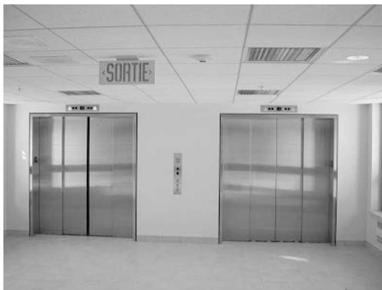
図 32 新設されたエレベーター
